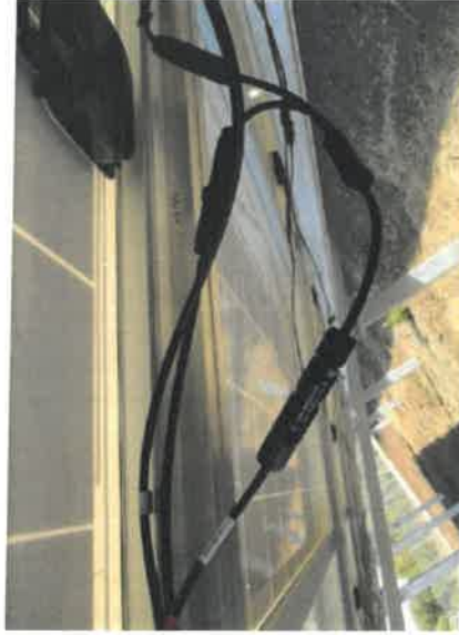
Figure 63 : Exemple de câble électrique et de boîte de raccordement (photo RES)
